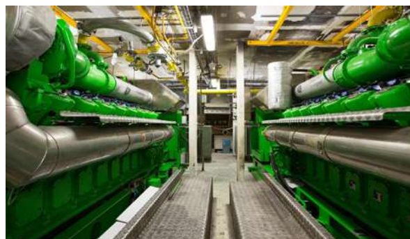
Au cœur de la centrale de géothermie de la Plaine des Bordes
